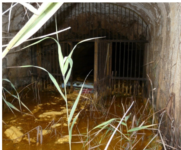
6. Estado actual del interior del túnel José Maestre parcialmente inundado con aguas ácidas.
