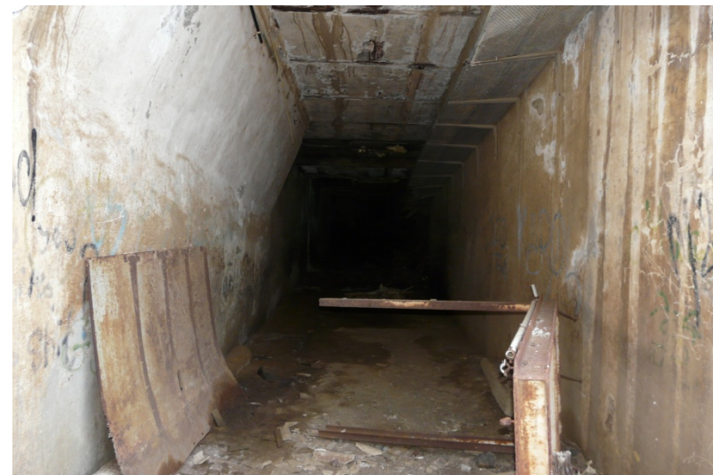
16 y 17. Estado actual del túnel de conexión con la tolva de descarga de los vagones del tren minero.
