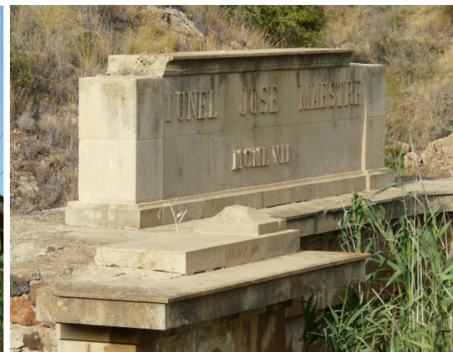
8. Estado actual de la parte superior de la fachada donde se aprecia el nombre del túnel y el año de construcción.
