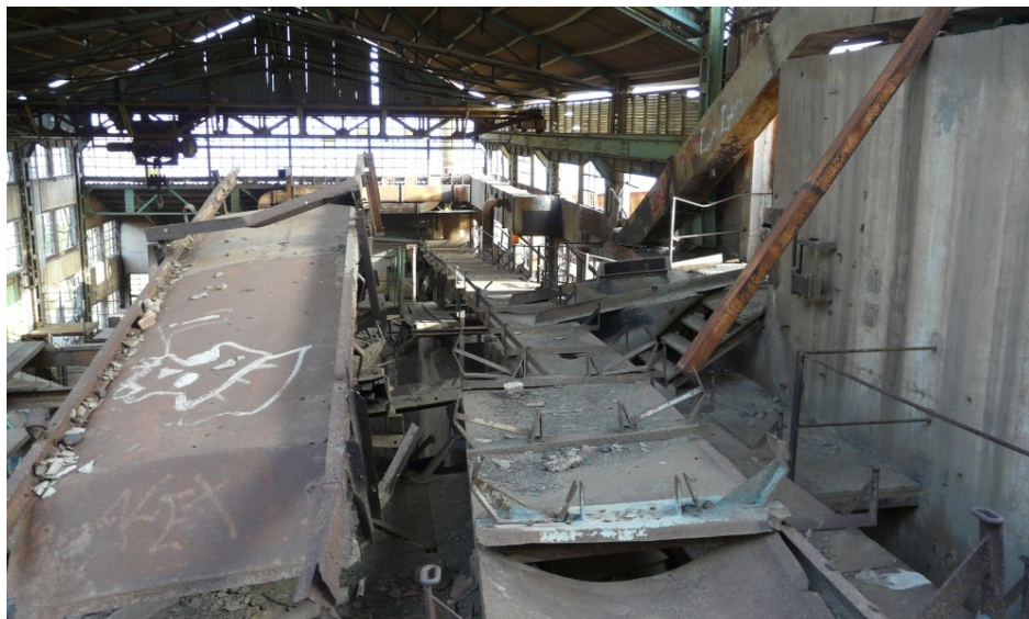
14. Estado actual de las estructuras por las que discurrían las cintas transportadoras en la molienda.
