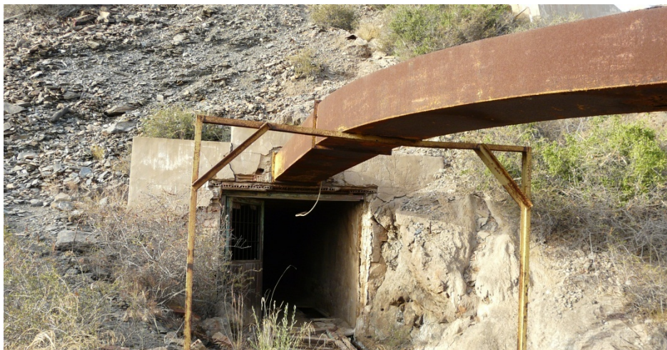
25. Conducciones y tuberías de aspiración y conducción del polvo hasta las torres de evacuación en forma de chimenea. En algunas de estas estructuras metálicas se aprecia un grado de corrosión muy intenso.
