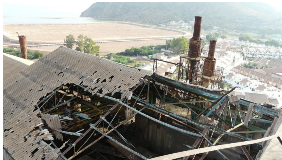
7. Estado actual del techo de la nave de molienda primaria del lavadero Roberto.
