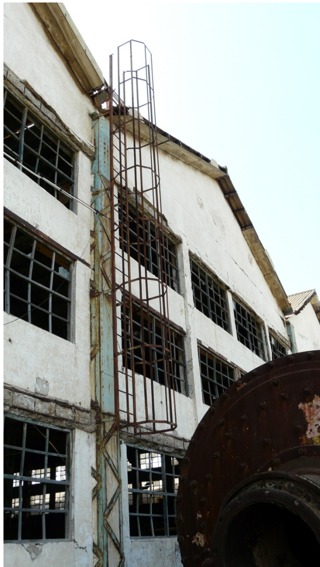
25 y 26. Estado actual del exterior de la gran nave de molienda y flotación del lavadero Roberto. En la foto de la derecha se aprecia la zona de la tolva desmantelada, que estaba conectada con la cinta transportadora desde la Trituración Secundaria.
