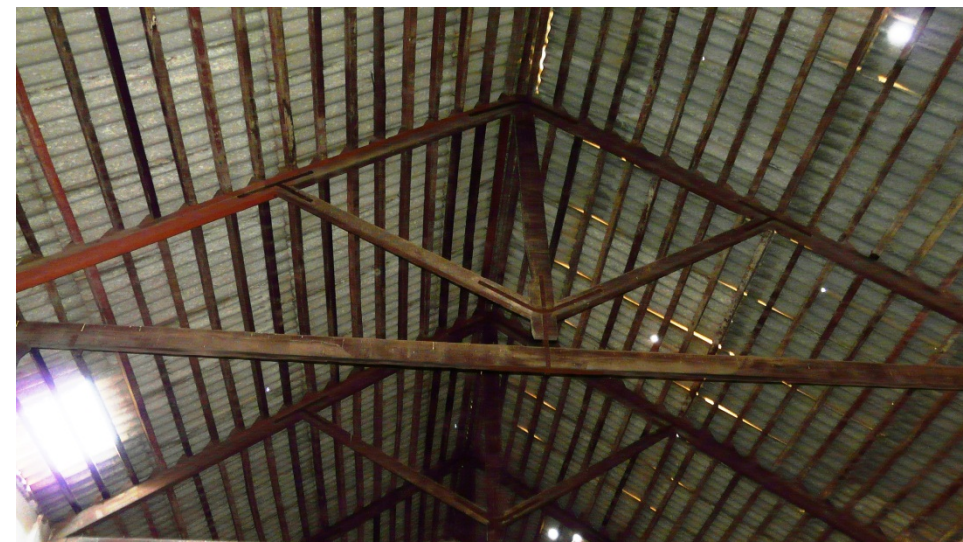
11. Estado actual de las cerchas de madera con refuerzos metálicos de la cubierta de la nave de talleres del lavadero Roberto.
