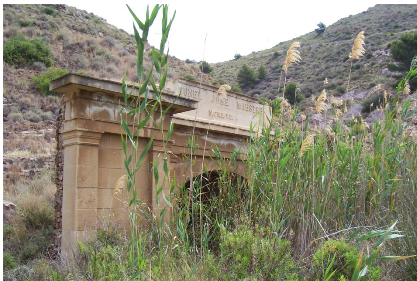
4. Estado de la entrada del túnel José Maestre en 2007.
