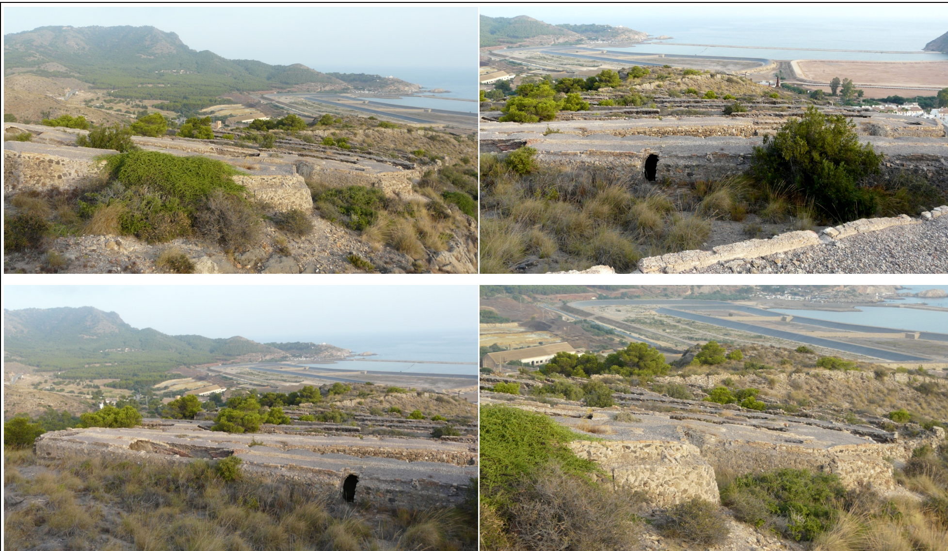
7, 8, 9 y 10. Estado actual de la galería de enfriamiento de humos o serpentín de la chimenea de la fundición Orcelitana.
