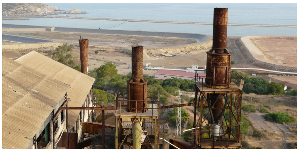
15. Estado actual de las chimeneas de evacuación del polvo en la planta de molienda primaria del lavadero Roberto.
