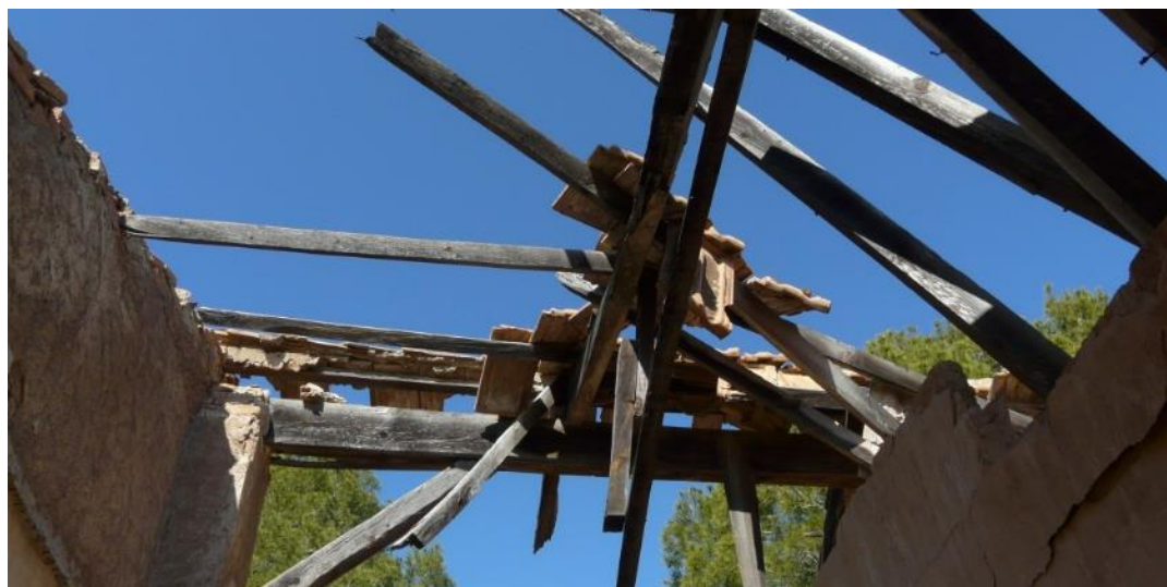
24. Estado actual de la techumbre de la vivienda de la mina Teresita.
