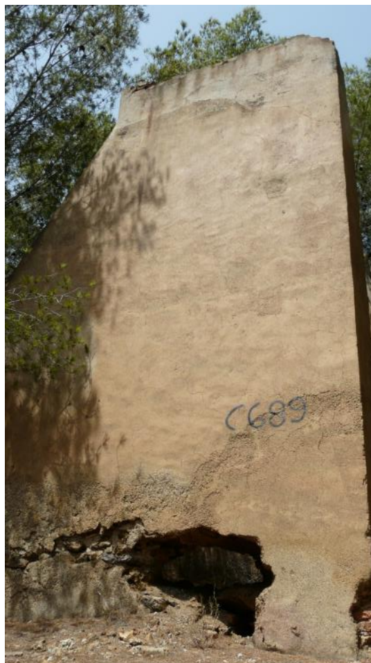
12. Muro oriental del castillete en el que se observa el gran agujero probablemente originado por el expolio de elementos metálicos o de madera (vigas).
