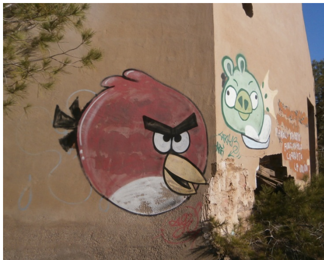
8. Muros con dibujos y grafitis en el edificio tolva del lavadero de flotación diferencial La Pinada.
