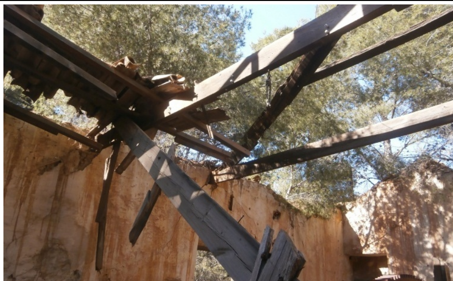
26. Estado actual del techo de la casa de máquinas con restos de cerchas y vigas de madera.
