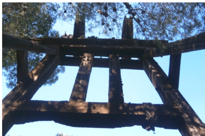
10. Estado actual de las maderas de la parte superior del castillete.
