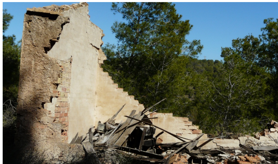
9. Estado actual de la edificación, actualmente en ruinas, que está situada al norte del complejo.
