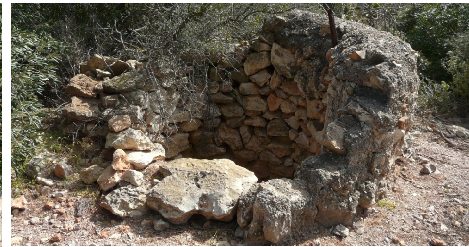
9. Pozo con el brocal semiderruido con grave peligro de caída en las instalaciones auxiliares de la mina La Cruz.
