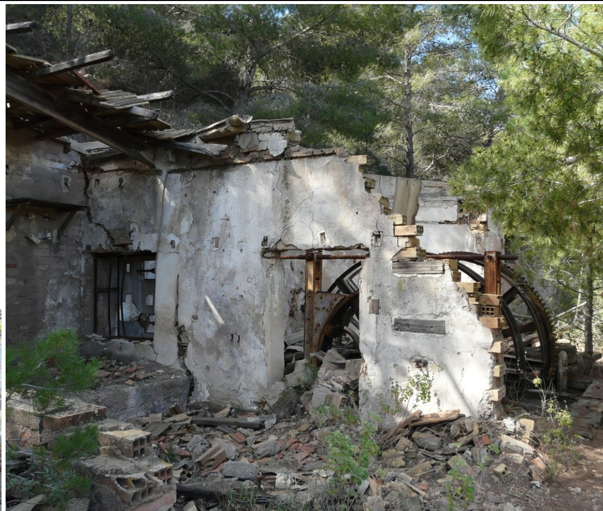
13. Estado actual del exterior de la casa de máquinas de la mina Secretaria.
