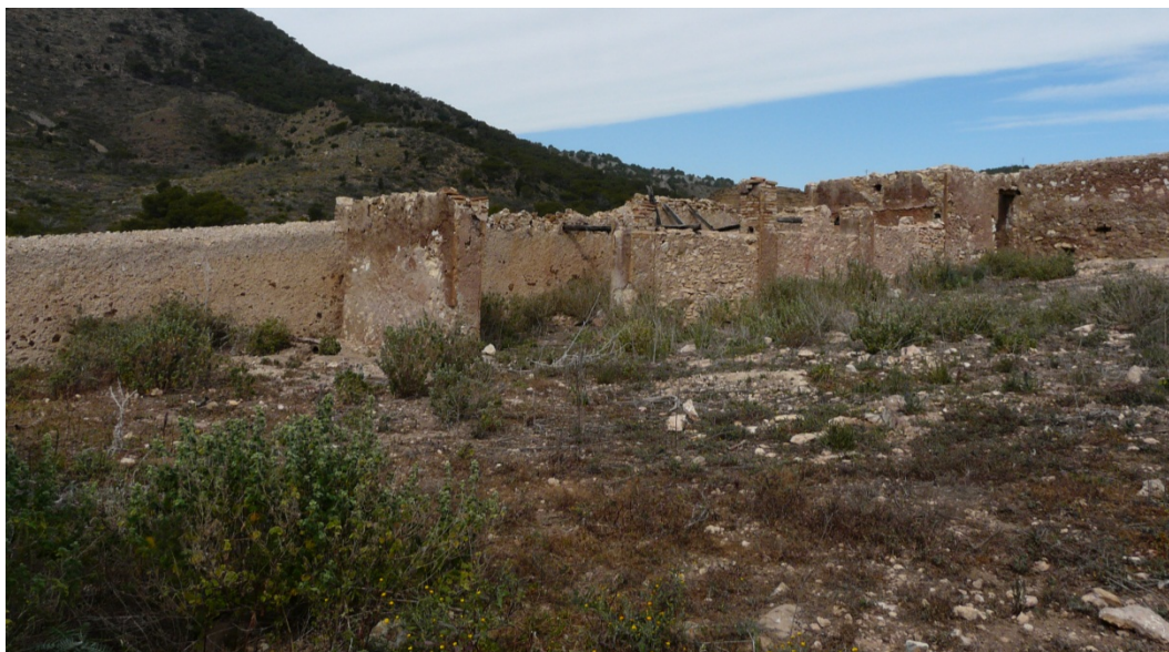
6. Vista general del estado actual de las dependencias localizadas en el interior de los patios del establo.
