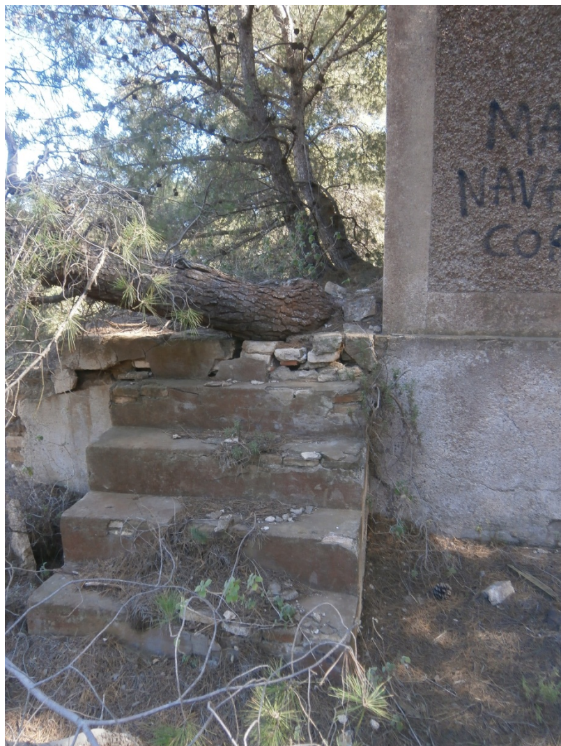
8. Estado actual de las escaleras de acceso al centro de transformación de electricidad de la mina Santo Tomás.
