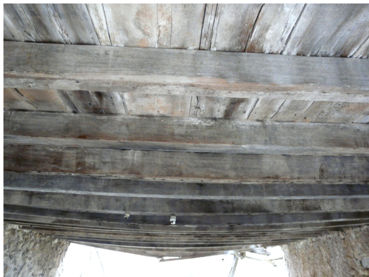
24. Estado actual de la techumbre de la planta inferior al borde del colapso.
