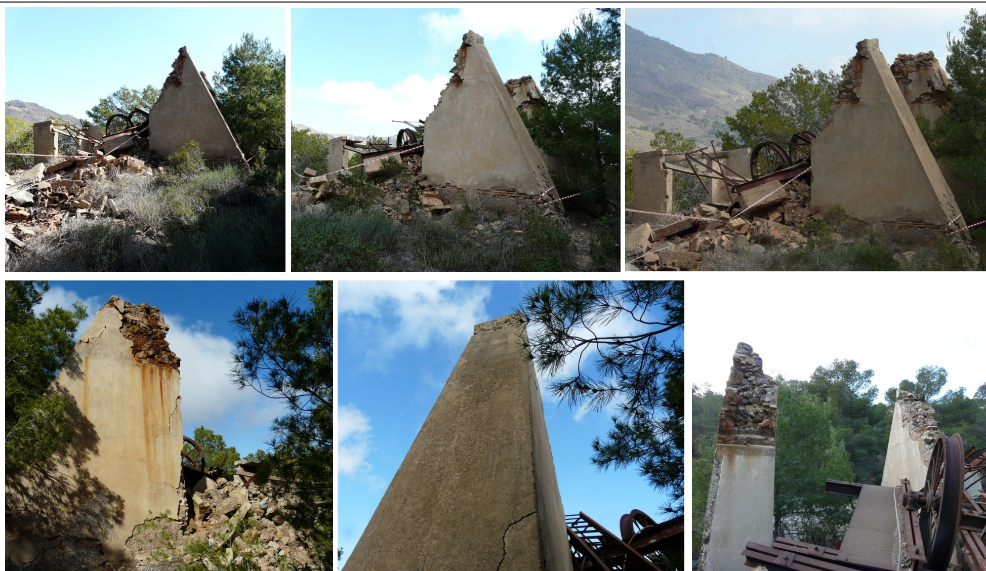
2, 3, 4, 5, 6 y 7. Estado actual del castillete de mampostería de la mina Secretaria que aparece parcialmente derrumbado.
