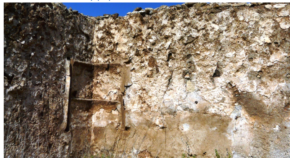
25. Estado actual del interior de la vivienda de las instalaciones minero-metalúrgicas de la mina Siete Dolores II.
