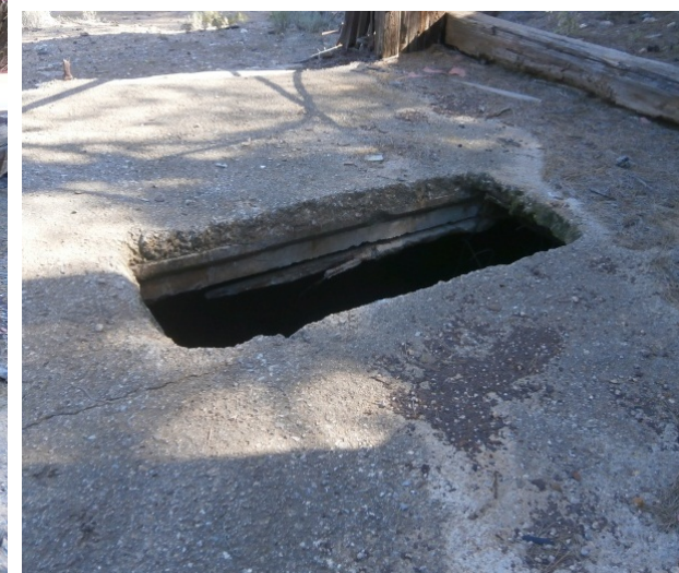
14 y 15. Estado actual del pozo maestro de la mina Santo Tomás cubierto con plancha de hormigón y hueco rectangular sin cerramiento.
