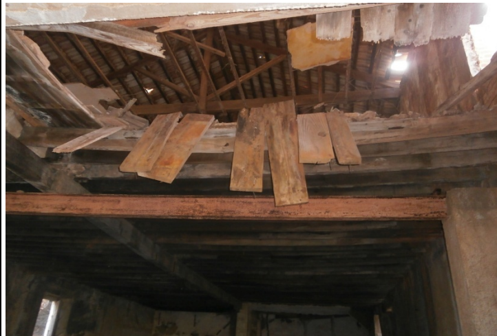
17. Forjado de vigas entre las dos plantas de la edificación que ha colapsado en algunas zonas.
