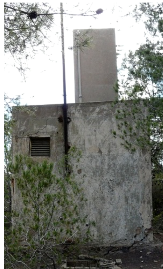
17. Vista general del estado actual del centro de transformación de electricidad de las instalaciones minero-metalúrgicas de la mina Secretaria.
