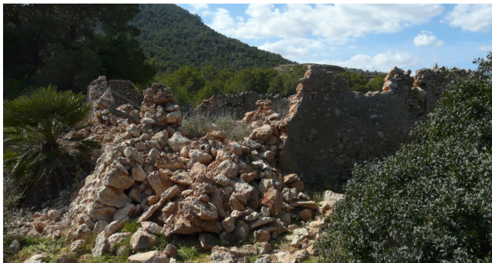
6. Estado actual de las instalaciones auxiliares de la mina La Cruz consistentes en un grupo de viviendas en ruinas.
