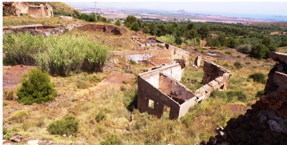
23. Estado actual del edificio de oficinas y vestuarios de la mina María Dolores.
