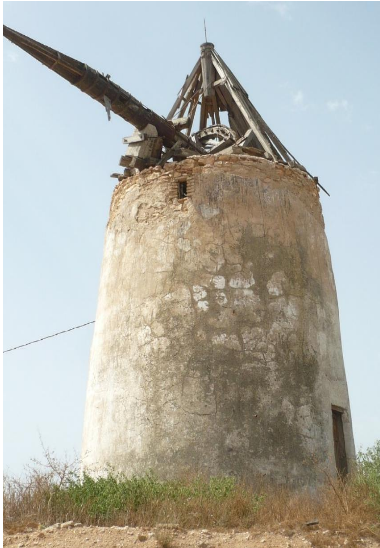
F7: Molino Gil. Alzado Norte. Vista acceso y maquinaria del aire / P1370900
