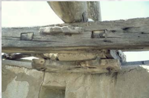
Figura 6: Detalle de los restos del telar y manzano sobre el que se apoya la piedra rabota. El mal estado, consecuencia de la ausencia de chapitel y tablazón, es patente.
