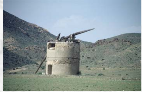
Figura 9: En esta imagen se aprecia cómo la rueda de puntería descansa sobre el eje del molino, al haber perdido riostras y travesaños.
