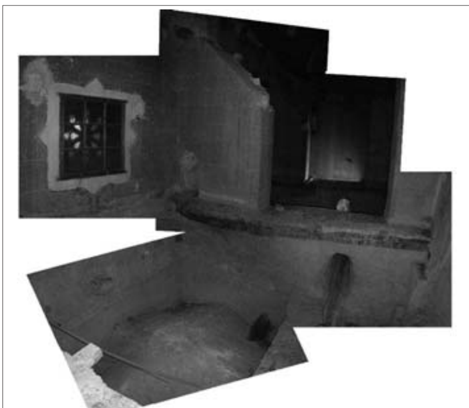
Fotografía donde se aprecia el estado previo de la zona bajo cubierta. Aparecen tirantes metálicos, colocación de cerramientos y carpinterías de madera, parches, agujeros, gran cantidad de polvo y suciedad, etc. Al fondo se observa un hueco en el muro que se ha aprovechado para el acceso a estas cámaras.
