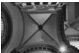
Arista nº 4 del Evangelio. Planta cuadrada. Pinjante central. Doble moldura. Patología: Fisuras.
