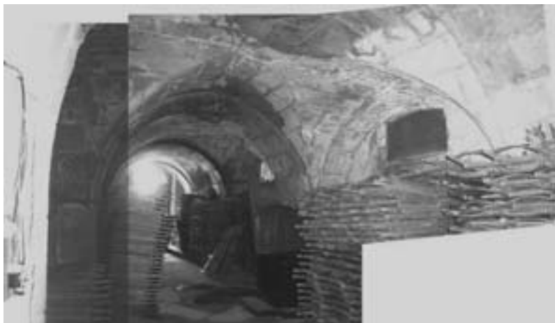
Dos imágenes del deterioro que se había alcanzado en el interior de la cripta.
