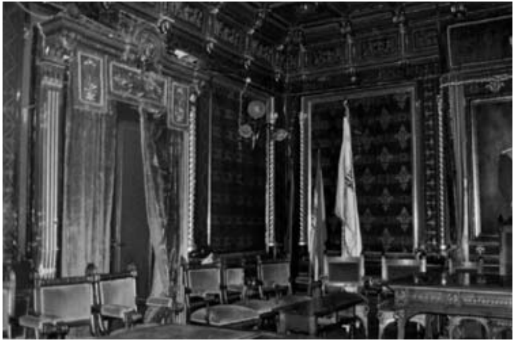
Salón de plenos, con detalle de la parte más dañada, apreciándose la rotura en las pilastras y otros motivos decorativos.
